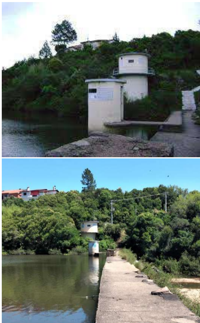
Figura 75 – Estação elevatória de água bruta
