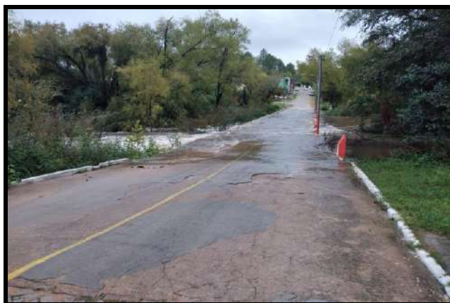
Figura 119 – Alagamento por água de arroio
